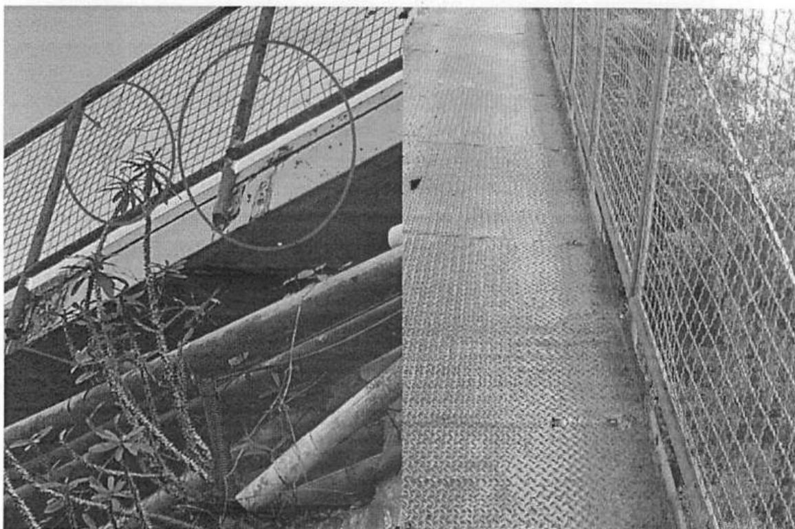
Figura 2. Vista da escada em direção ao guarda corpo da passarela, presença de vegetação na cabeceira da ponte.
